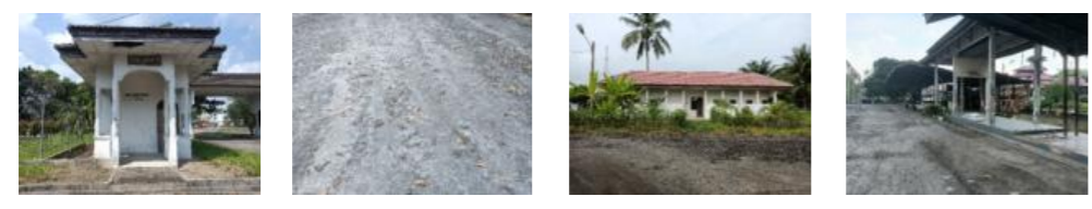
Beberapa fasilitas umum yang rusak pada terminal Madya Kisaran.
