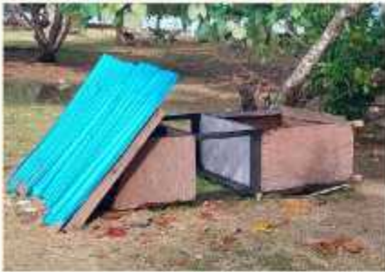
Bangunan mudah rusak karena angin/hujan
