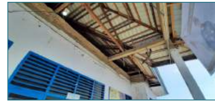
Kerusakan pada bagian
