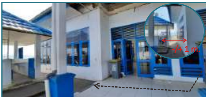
Koridor / jalur keberangkatan dan kedatangan yang sempit dan tidak ramah bagi penyandang disabilitas
