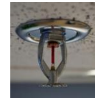
Sprinkler yang di pasang pada plafon dalam bangunan
